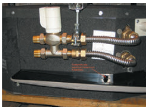
Поддон для сбора конденсата (внешний) и запорно-регулирующий узел смонтированы на кассетном фанкойле
